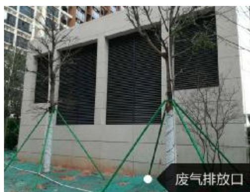
图 6-8 发电机废气排放口
