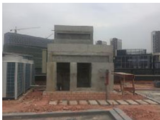
图 6-5 楼顶烟道排气口
