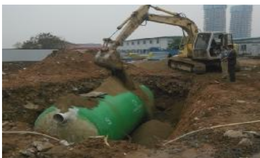
图 5-4 施工营地化粪池
