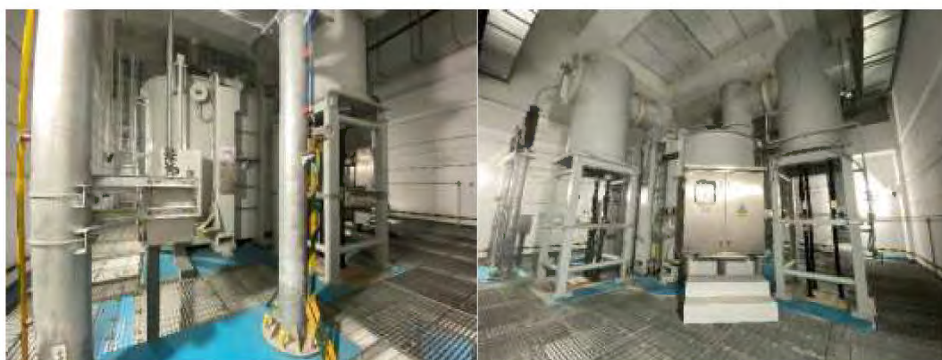
图 2.10-2 双龙变电所主变电设备
