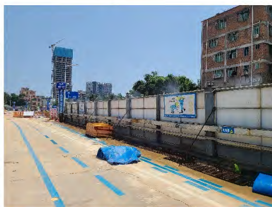
围挡喷淋设备
